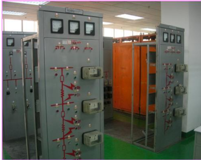
二次线路安装实训室
