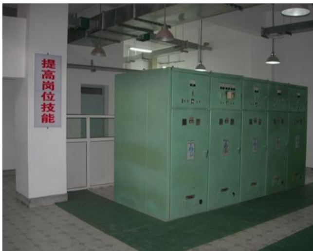
高压电气技术实训室
