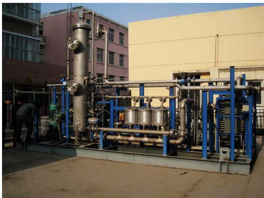
庆阳石化捐赠的汽油尾气除臭装置
