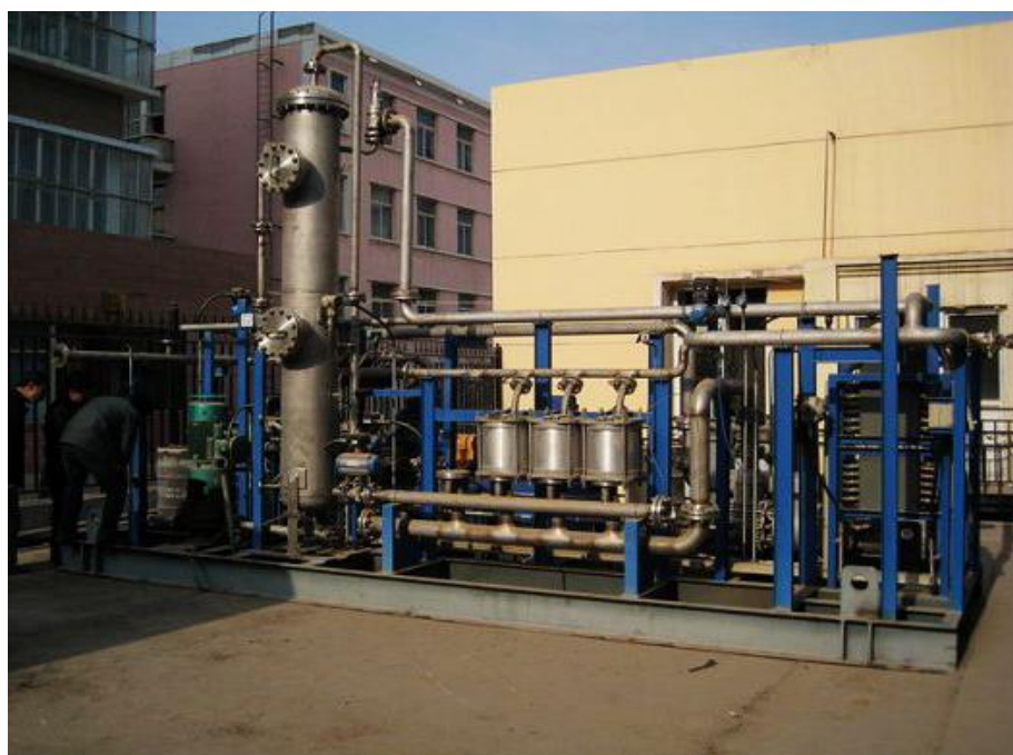
庆阳石化捐赠的汽油尾气除臭装置
